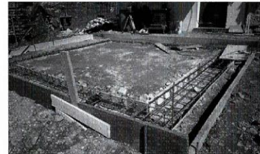
"Platea tettoia fotovoltaico Malga – Agriturismo Plan dai Spadovai"
